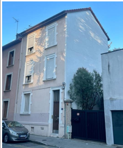
Pignon isolé avec du liège, Grenoble
