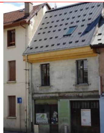
épaississement de la rive de toit due à une isolation mal gérée
